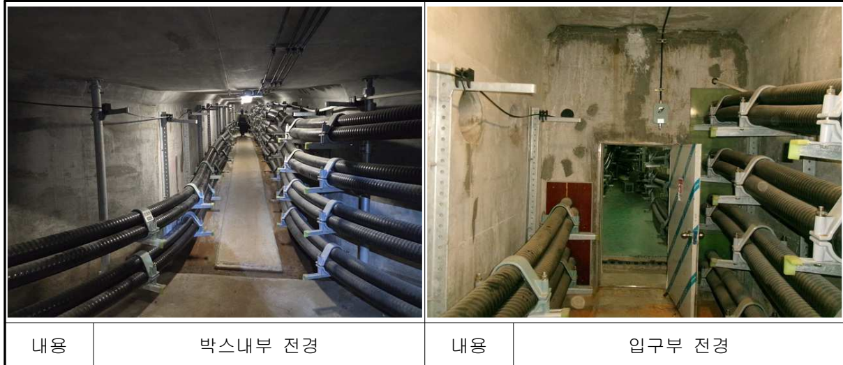
【사진 3.1】 문발SS인출 전력구 현황
